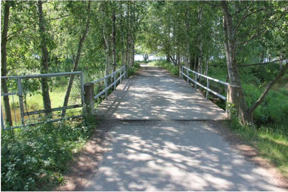
104. Tukkiisaaren ja rantatörmän välissä kulkee kapea uoma. Sen yli johtaa ajoneuvon kantava teräsbetonikantinen silta, joka on rakennettu Uiton talon tapaan vuonna 1938.
