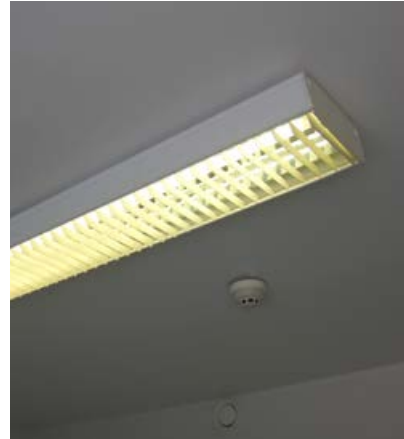
198. Asuinhuoneen yleisvalaisimenä on tyypillisesti kookas loisteputkivalaisin.
