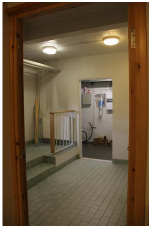
264. Näkymä pukuhuoneen ovelta. Vasemmalla näkyvät portaan johtavat ulko-ovelle. Perällä näkyy sähköpääkeskus.
