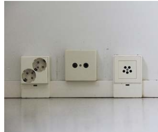
202. Lattialistaa on käytetty yleisesti johtokouruna.
