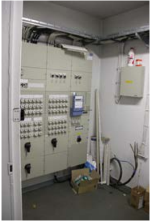
196. Sähköpääkeskus on uusittu 1990-luvun peruskorjauksessa
