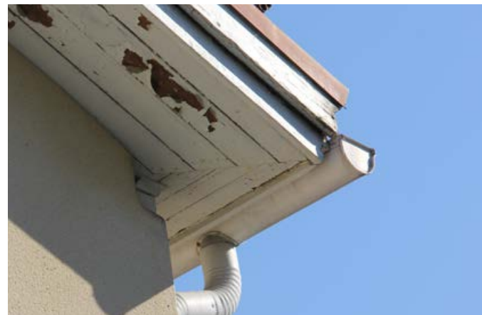
129. Vesikatto tuulettuu nykyisin sivuräystäiltä ja myöhemmin lisättyjen harjatuulettimien kautta. Räystäiden aluslaudoitus on muodoltaan alkuperäinen. Maalin lohkeilu viittaa puutteelliseen tuuletuvuuteen.
