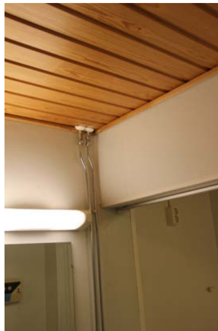
259. Vanha väliseinä pukuhuoneen ja suihkutilan väliltä on purettu. Sen yläosa on jätetty palkiksi.
