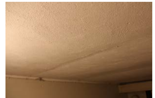
163. Kellarin itäosan laboratorion alakatto on rapattua toja-levyä.
