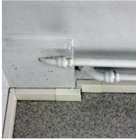
210. Vanhimpia keskuslämmityksen putkituksia ulkoseinässä.
