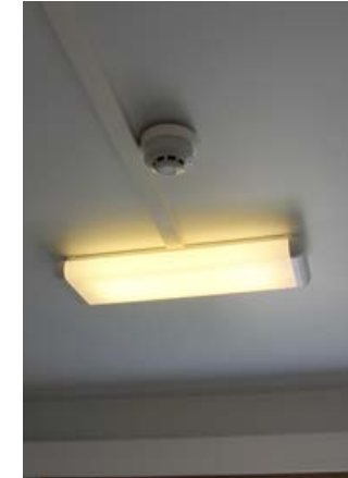
200. Yhden hengen huoneen yleisvalaisin katossa.
