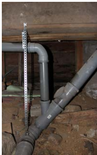
282. Uusittuja viemäriputkia ryömintätalassa. Putkia ei ole eristetty.
