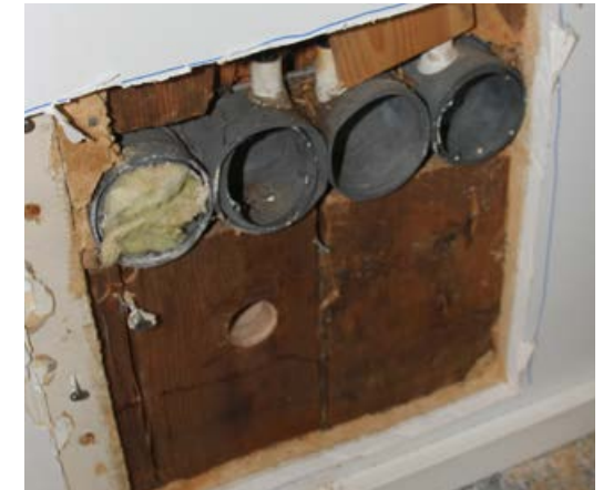
204. Vanhoja lyijykuoria sähkörasioita ulkoseinässä.
