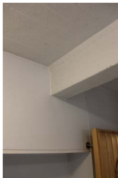
272. Kellarin paikalla valetussa alapalkkilaatassa näkyy valumuotin lautakuvio.
